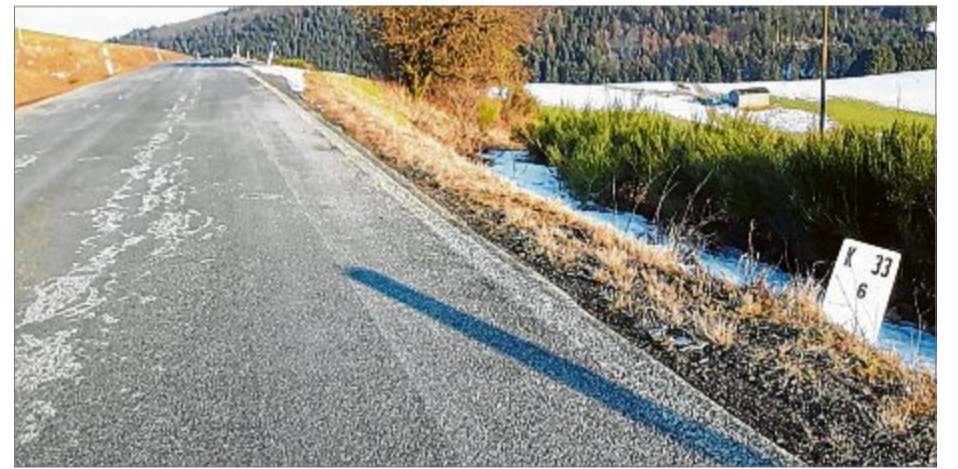
Die Fahrbahn der Kreisstraße 33 zwischen Rüppershausen und Steinbach soll in diesem Jahr erneuert werden. Foto: Björn Weyand
